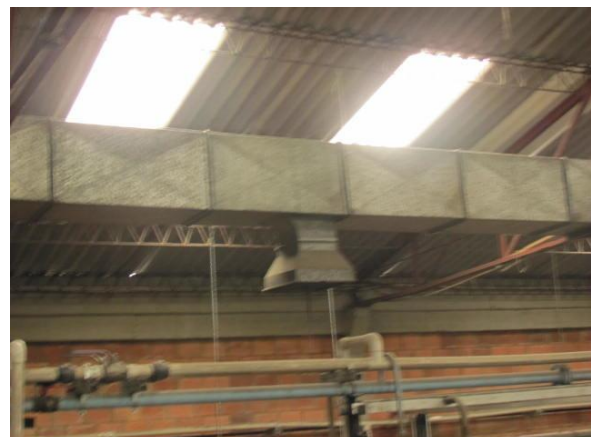
Figura 7: Ducto de Ventilación
