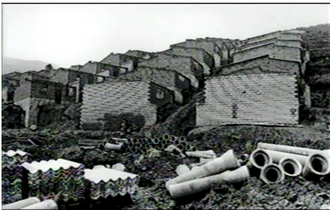
Foto 6. Construcción de vías peatonales, casas y redes de servicios públicos en el barrio Pablo Escobar en 1983 (aproximadamente).
