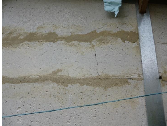
Imagen 40. Panel de pared quebrado.
