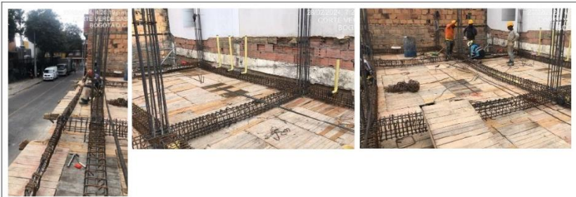
Instalación de aceros para a placa – Nivel 2,65 Montaje de aceros según despiece y diseño estructural para zaparas, vigas y columnas del piso 2.
