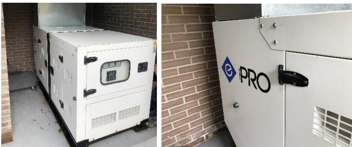
Ilustración 23. Planta eléctrica ePRO ver Anexo 3. Fuente: Elaboración propia.
