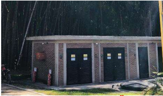
CUARTO ELÉCTRICO Y PLANTA ELÉCTRICA
