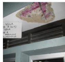
Foto 9 Estructura 4. Mezzanine Viga eje K(2-3). Regata.
