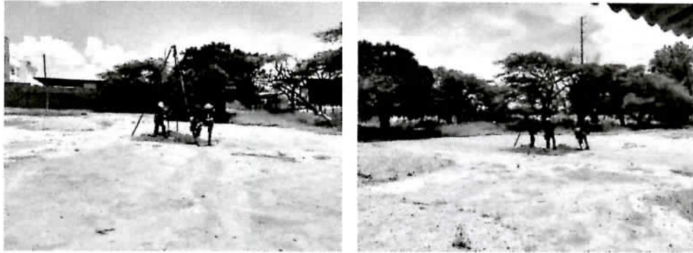
Sondeo 2. Pruebas iniciales de penetración
