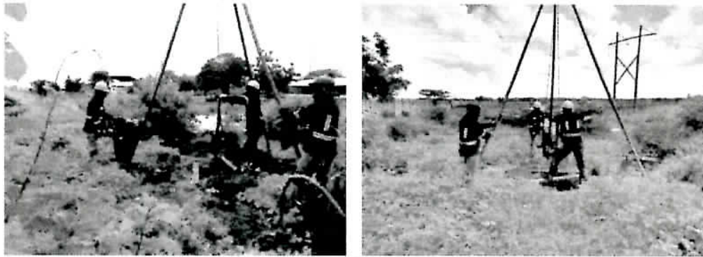
Sondeo 3. Pruebas iniciales de penetración
