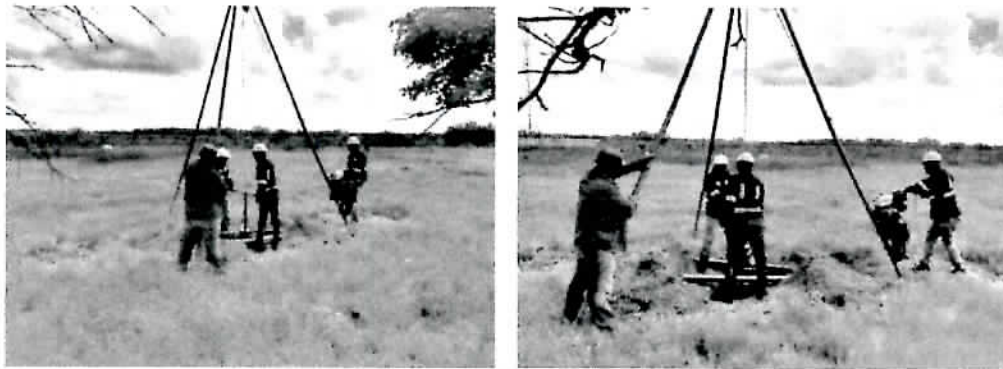
Sondeo 5. Pruebas iniciales de penetración
