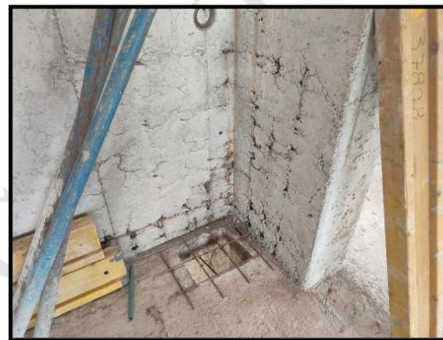
Foto No.11 y 12 (30 de abril de 2026): General, Se requiere realizar reparaciones estructurales en elementos fundidos con acero expuesto.
