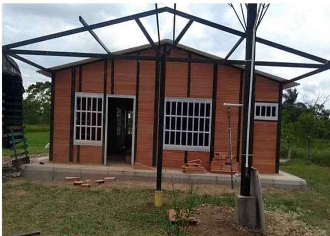
Ilustración 11. Casa prefabricada Riel placa fácil
