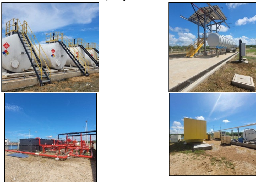
Figura 21. Sistema de almacenamiento y despacho de condensados
