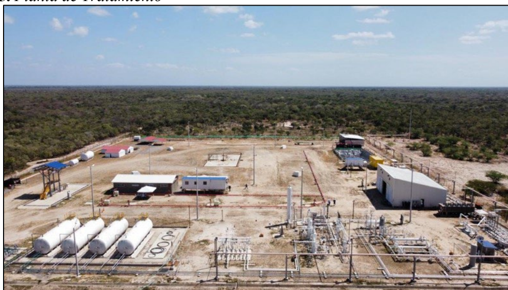
Figura 15. Planta de Tratamiento
