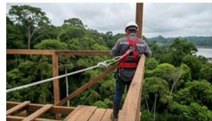
F. PROTECCIÓN CONTRA CAÍDAS: LÍNEA DE VIDA Y ARNESES CERTIFICADOS
