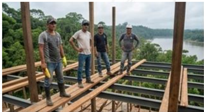
Antes: USO PARCIAL E INCORRECTO DE EPP (Inicio Proyecto)
