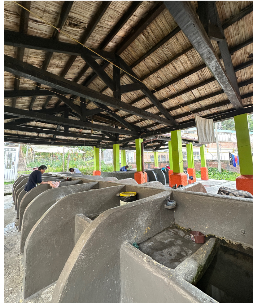
Lavaderos comunitarios: barrio Antigua Fábrica de Loza
