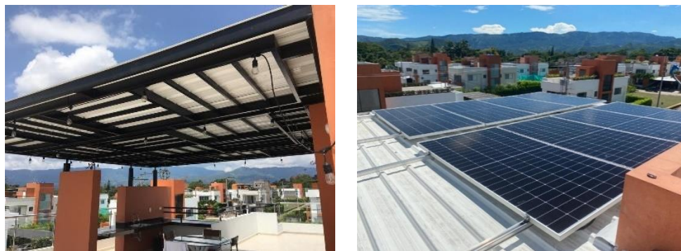
Imagen 2 del Anexo 9. Fotos de la instalación del sistema
