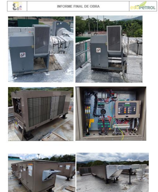
Adicionalmente se cuenta con un equipo multi-split para el acondicionamiento de las áreas comunes como pasillos y cuarto de tableros de control.
