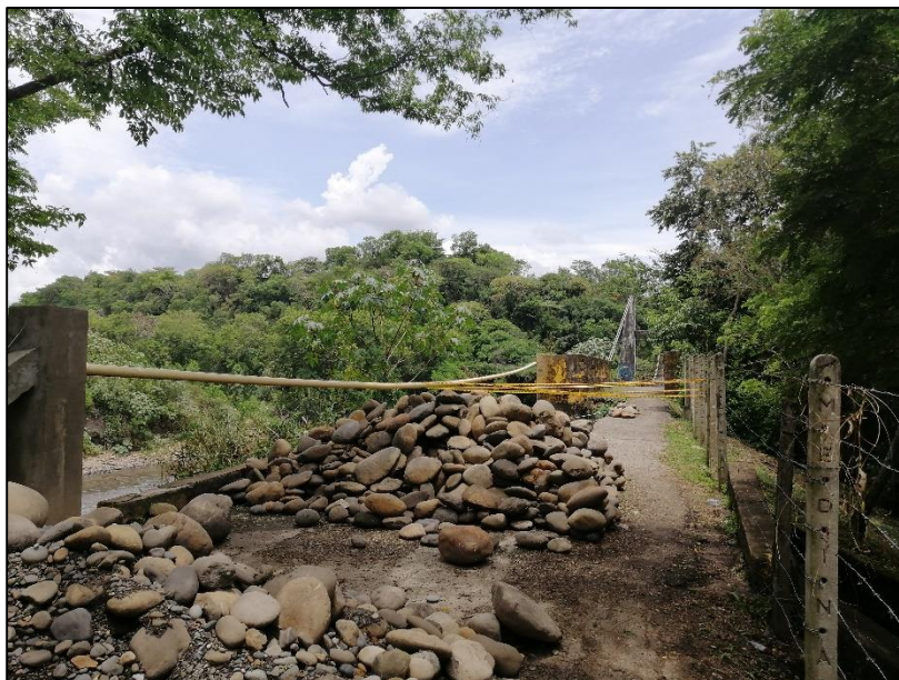
Imagen 4: Cierre del “Puente de los Suspiros” por peligro a derrumbe a día de hoy 73
